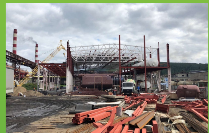
Котельная. Губахинский КОКС. г.Губаха
